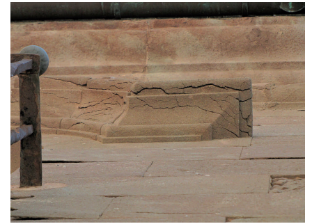
Elements de les cornises dels balcons abans de la restauració
